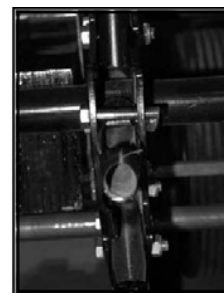
Fig.5: Positionnement de boulon incorrect
