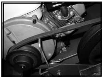
Fig.13: Ceinture d'entraînement incorrectement installée
